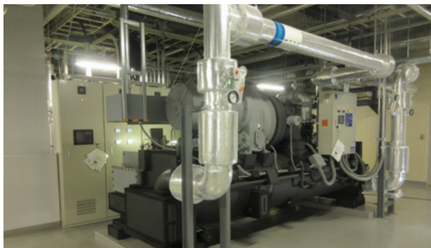
ターボ冷凍機(持田製薬工場(株)本社工場・2022年4月～2024年2月更新)
