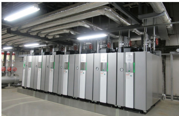
ガス焚き貫流ボイラー(持田製薬工場(株)本社工場)
