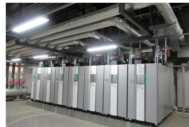
ガス焼き貫流ボイラー(持田製薬工場(株)本社工場)
