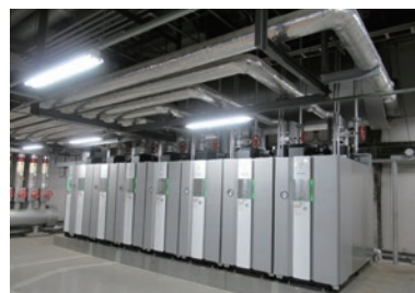
ガス焚き貫流ボイラー (持田製薬工場(株)本社工場)
