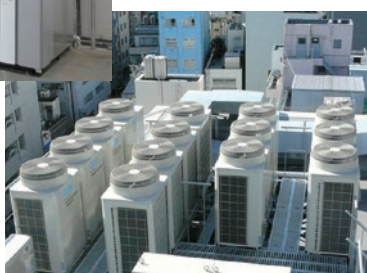
省エネルギー型空調設備 (持田製薬(株)本社)
